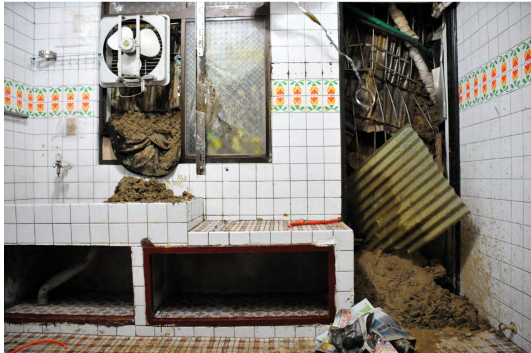
邊坡土石崩塌，土石流衝入民宅。 攝影 / 游錫璋 地點 / 基隆市中正區 2013.09.01
