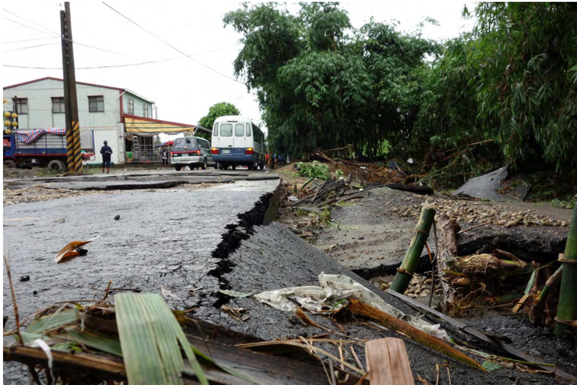
路面遭大水沖刷龜裂損壞。
