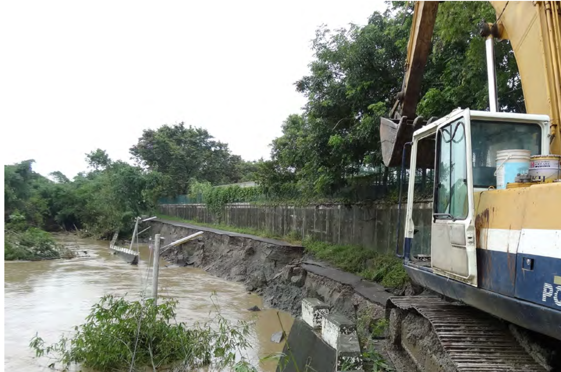
路面被大水沖刷損毀。 攝影 / 簡瑞騰 地點 / 嘉義縣大林鎮 2013.09.01
