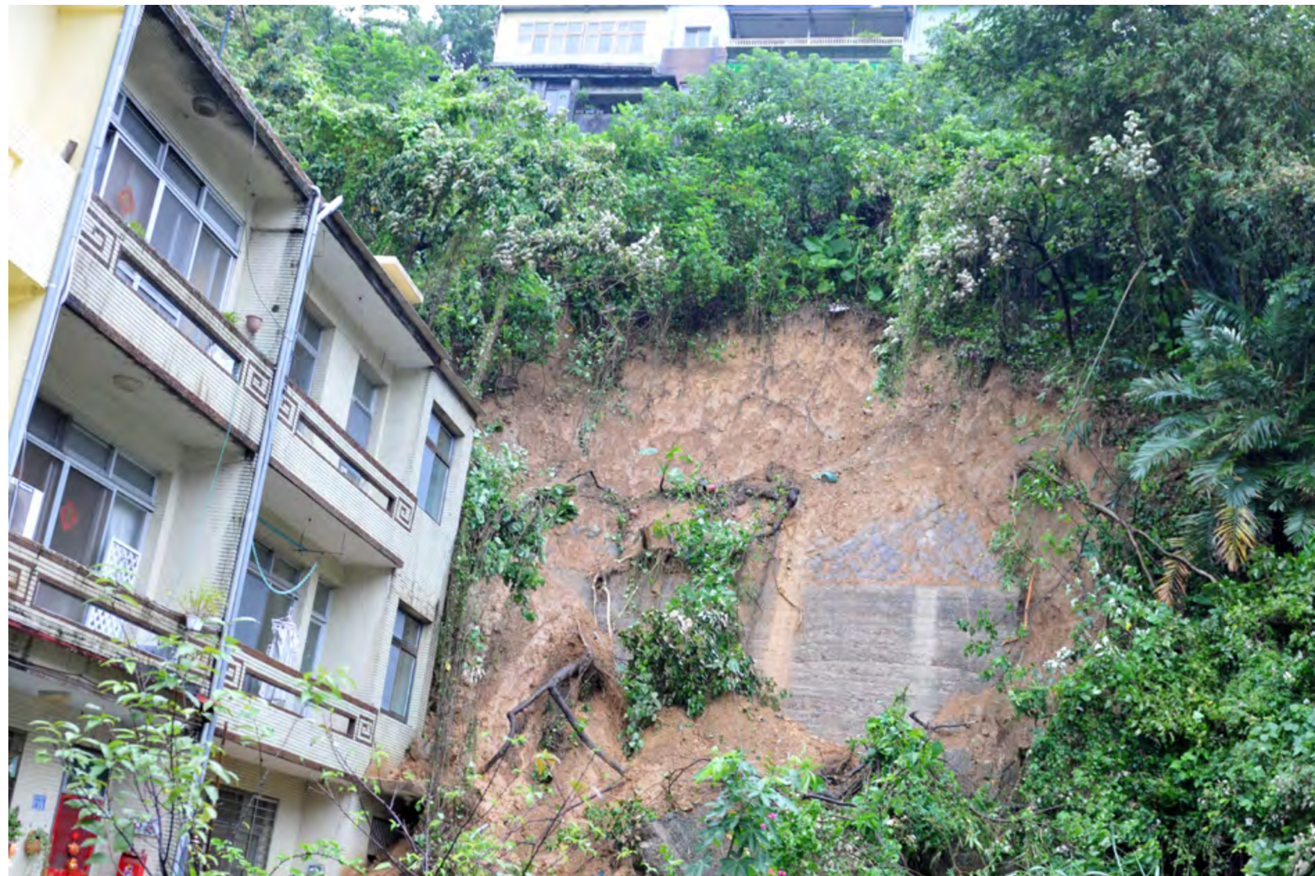
颱風帶來豪雨，造成山崩及土石流侵襲民宅。 攝影 / 游錫璋 地點 / 基隆市中正區 2013.09.01
